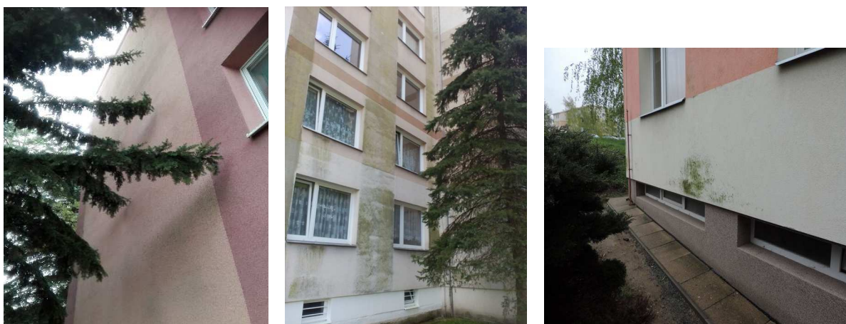
Obr. 5 – 7: příklady nevhodné blízkosti zelené vegetace a její důsledky.
