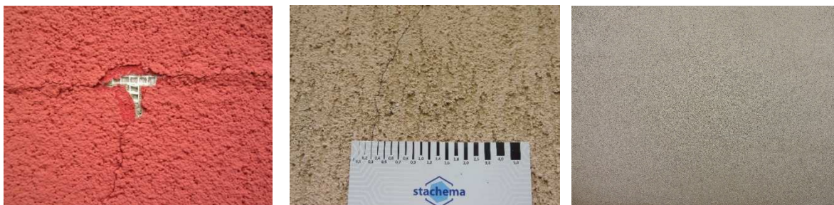
Obr. 29 – 31 Příklady trhlin a prasklin na fasádě s ETICS.
