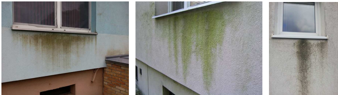
Obr. 8 – 10: Příklady a důsledky špatně odizolovaného parapetního oplechování.
