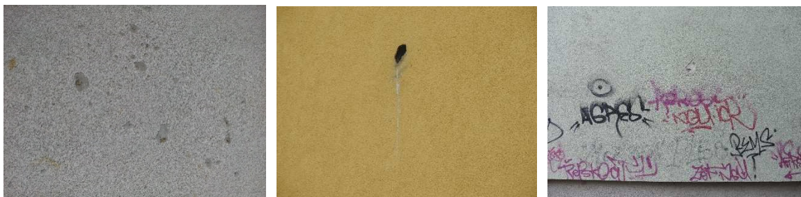
Obr. 20 – 22 Příklady poškození fasády s ETICS vandalstvím a ptáky.
